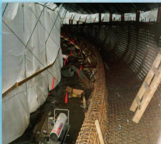
F2: Se utilizan mantas, calentadores, encofrados con aislación y barreras rompiewentos para proteger al momento de hormigonar.
