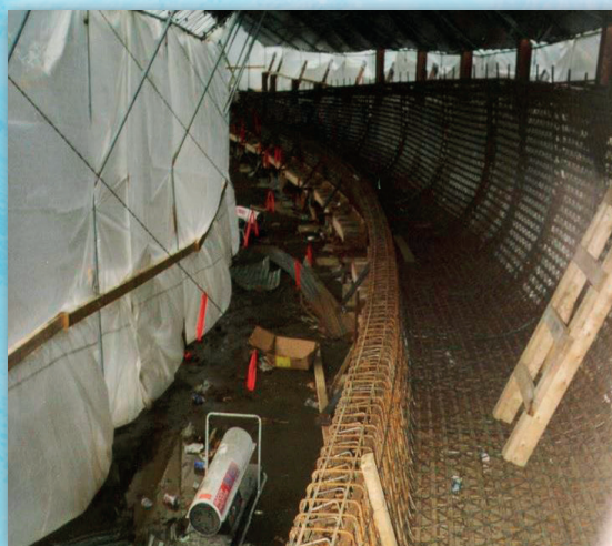
F2: Se utilizan mantas, calentadores, encofrados con aislación y barreras rompevientos para proteger al momento de hormigonar.
