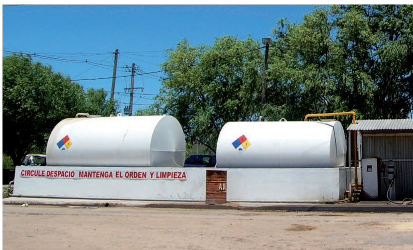
▲ F. 18 Muro antiderrame
