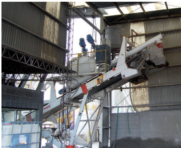
▲ F. 6 Vista interior de Box de carga
