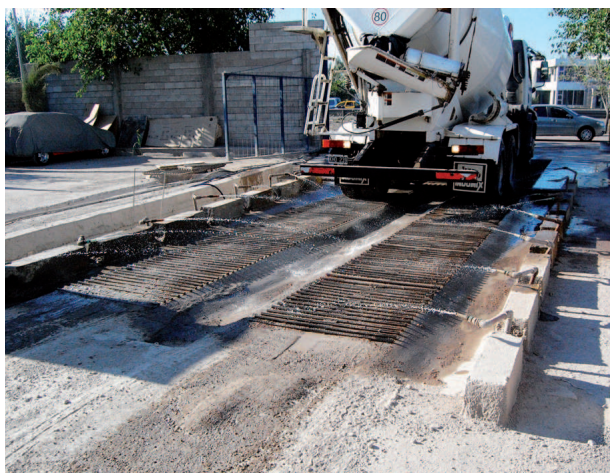
▲ F. 1: Rejilla de contención para el lavado de neumáticos
