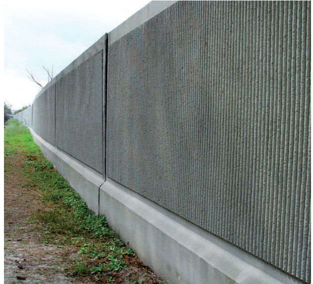
▲ F. 13 Muro para contención sonora
