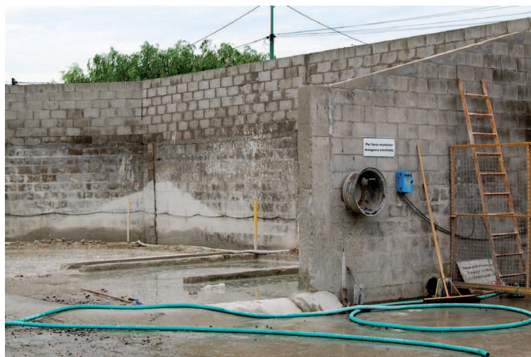
▲ F. 11 bis Sector de lavado de equipos
