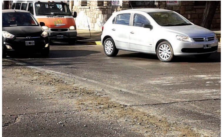
▲ F. 15 Derrame en vía pública
