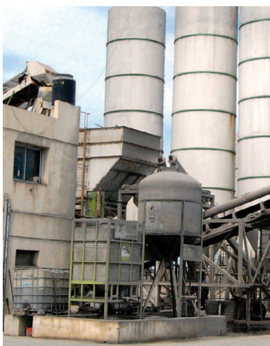
▲ F. 17 Murete antiderrame de aditivos
